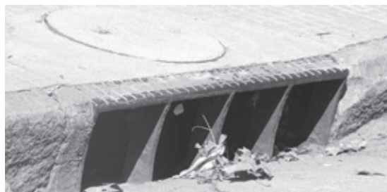
Boca de tormenta
